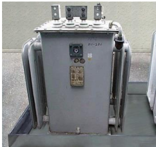
変圧器（トランス）
