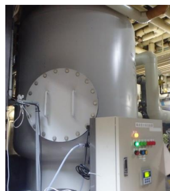
写真2 公衆浴場の循環ろ過設備(写真左)とモノクロラミン自動添加装置(写真右下)。
