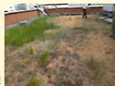
維持管理不足での枯損
