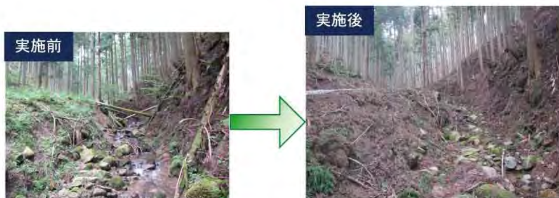
写真 【災害緩衝林整備事業実施状況】（溪流部の対策）伊賀市（口那須ヶ原）
