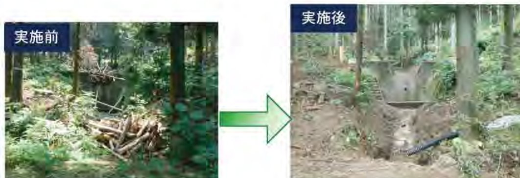
写真 【土砂・流木緊急除去事業実施状況】 大紀町（三本松） 崩壊土砂流出危険地区の溪流部において、流木になる恐れのある危険木を伐採・除去しました。
