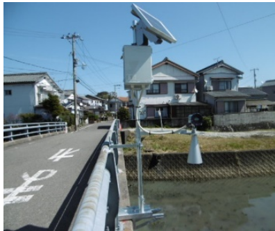
危機管理型水位計 （三重県）
