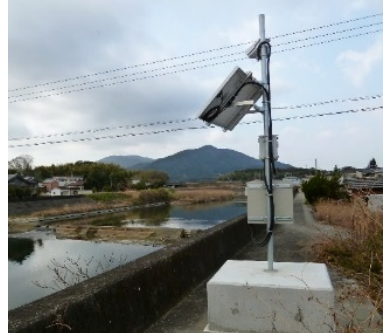
簡易型河川監視カメラ （三重県）
