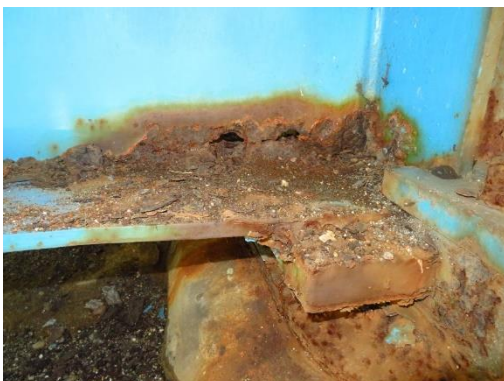
老朽化により桁・支承が腐食
