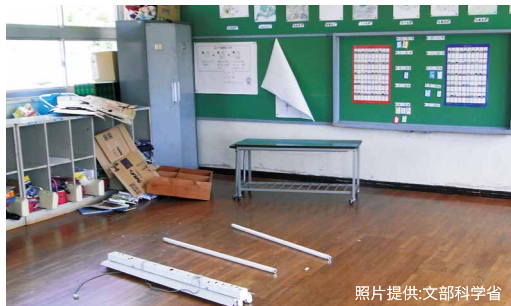
掉落的日光灯
