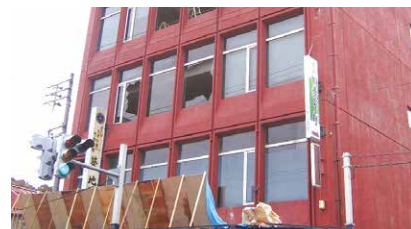
破损、掉落的窗户玻璃
