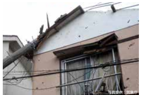
たお でんちゆう こわ いえ 倒れた電柱で壊れた家
