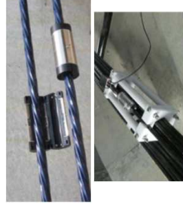
センサーによる橋梁ケーブル張力のモニタリング
