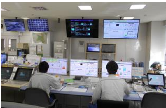
高野浄水場中央監視の状況
