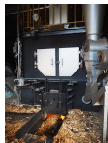
乾燥用の木質バイオマスボイラー
