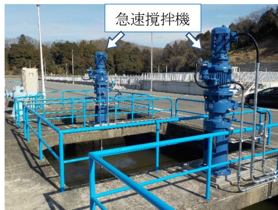
更新後の急速攪拌機 (山村浄水場)
