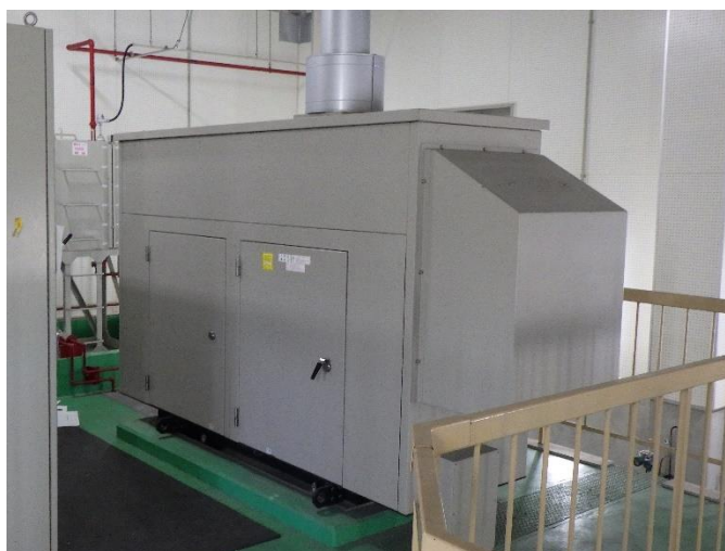
更新予定の非常用発電設備（平成10年度設置） （桑名加圧ポンプ所）
