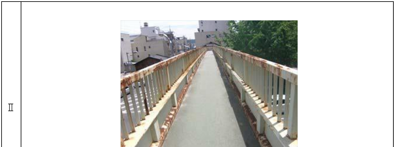
例：局部で腐食が進行しつつあり、放置すると影響の拡大が見込まれる場合
