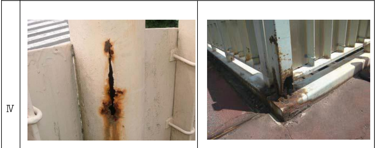
例：明らかな断面欠損、貫通や著しい板厚減少がある場合
