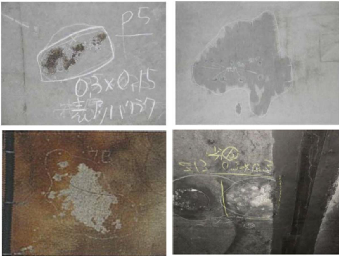
付写真-2.4.2 覆工コンクリートが変色している例 (うき・はく離を伴う)
