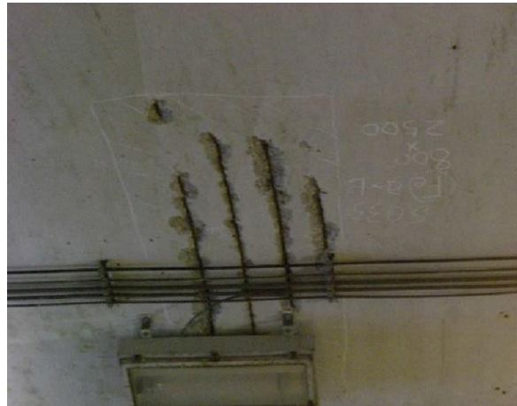
付写真-3.1.2 鋼材腐食の例
