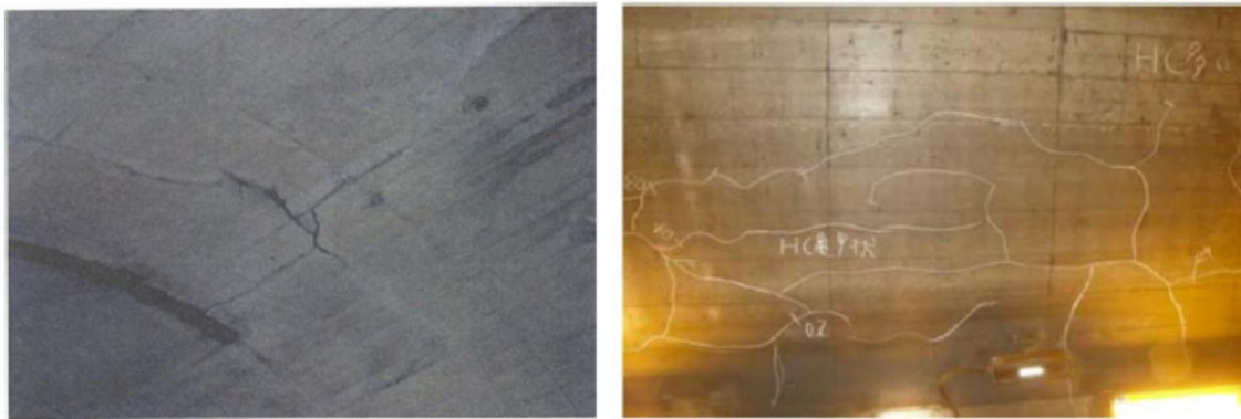
付写真-2.4.1 複数のひび割れで覆工コンクリートがブロック化している例
