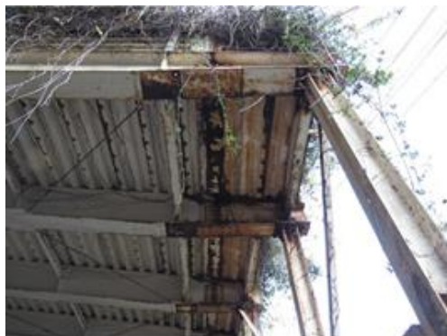
主梁・横梁・頂版の腐食
