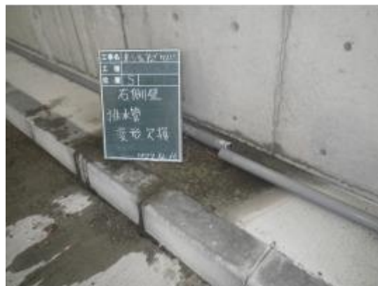
排水管の変形・欠損
