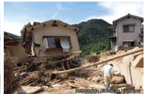
Deslizamento de terra
