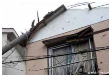
被倒塌的电线杆砸坏的房子
