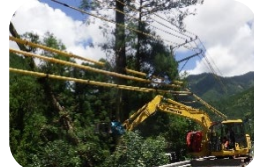
電線沿いの危険木の事前伐採
