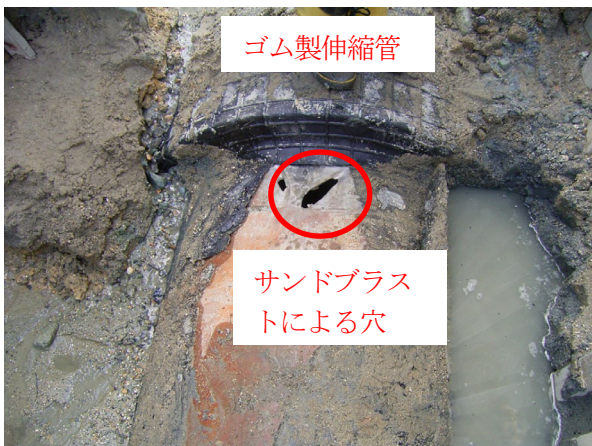
写真 掘削後の漏水箇所の状況
