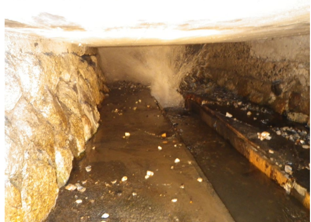
写真 水路への漏水状況
