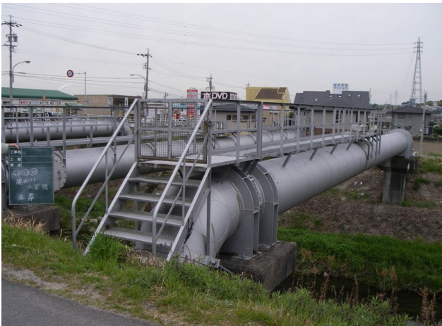
図-13 鹿化川水管橋（3条のうち中央が二期前期）
