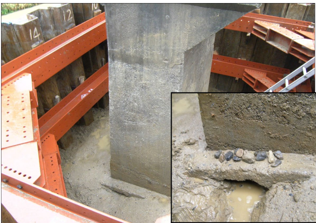
図-14 フーチング基礎施工不良
