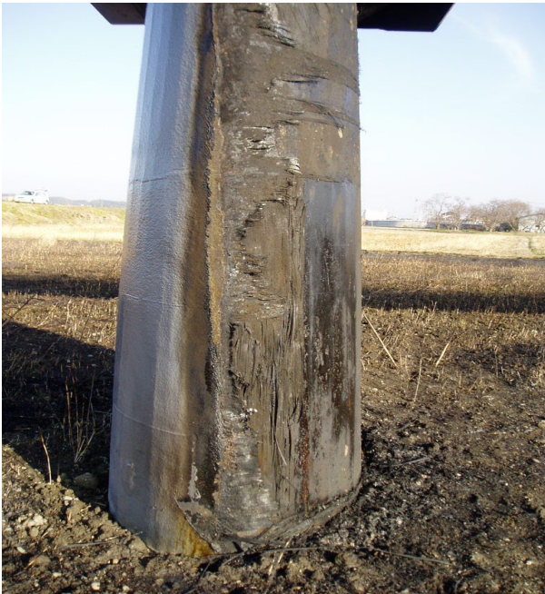
図-9 火災により一部耐震補強部が損傷した橋脚
