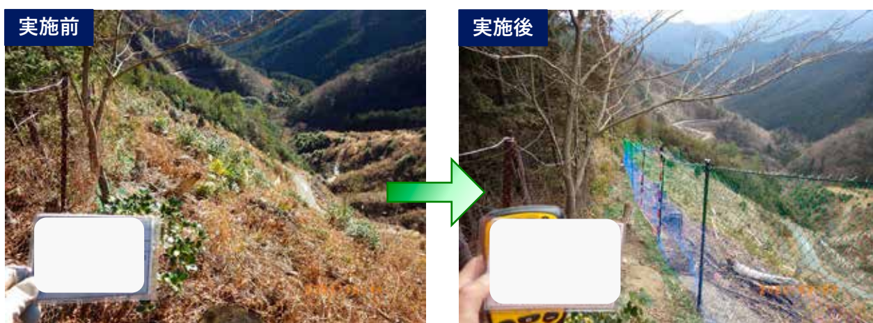
獣害防止施設の設置状況（松阪市）
