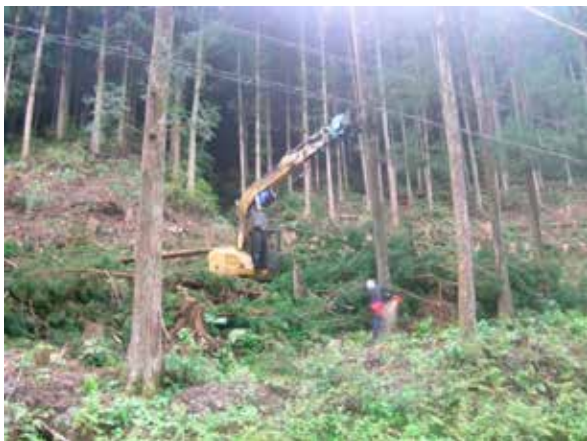
災害からライフラインを守る事前伐採事業 電線沿いの危険木の伐採
