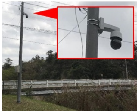
危機管理型水位計 （菰野町）
