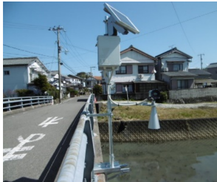
危機管理型水位計 （三重県）
