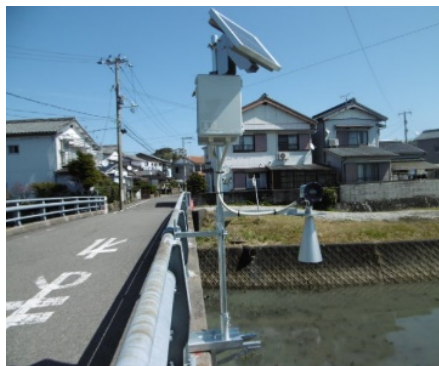
危機管理型水位計 （三重県）
