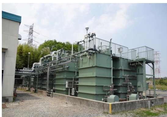
汚染地下水を浄化する水処理施設
