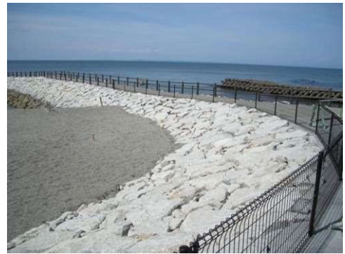
【離岸堤・突堤】 自然石を用いた突堤を整備し、自然景観との調和に配慮 (宇治山田港海岸／伊勢市)
