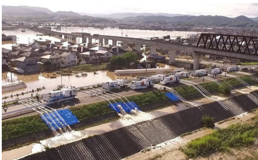
(排水ポンプ車作業状況②：出展 国土交通省)
