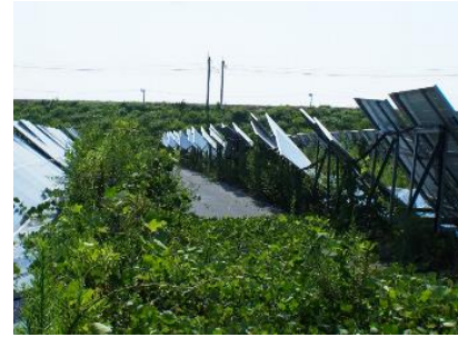
不十分な管理で放置されたパネル
