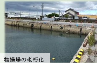
物揚場の老朽化
