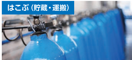
水素貯蔵タンク、水素液化システム、各種水素貯蔵材料、輸送用船舶・コンテナ、水素ステーション、パイプライン、その他水素・アンモニア貯蔵・供給関連製品・技術 他
