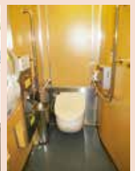
多目的トイレ
