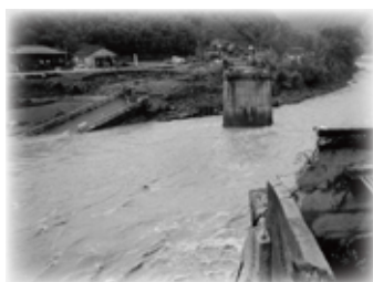
令和 2 年 7 月豪雨(熊本県球磨川) 写真提供：国土交通省九州地方整備局
