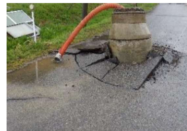
能登半島地震下水道施設被災状況
