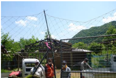
防護柵のかさ上げ
