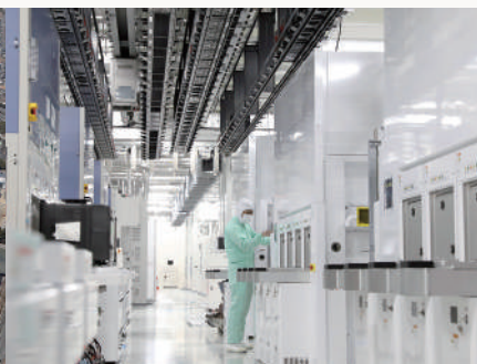
クリーンルーム
