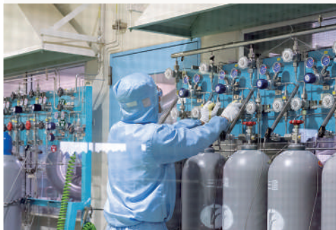
クリーンルーム
