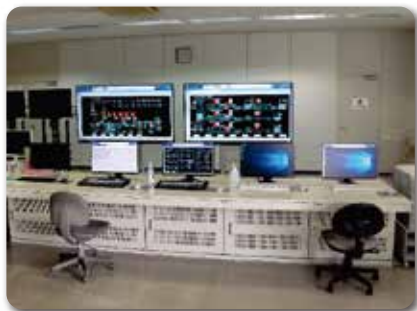
更新した中央監視制御設備
