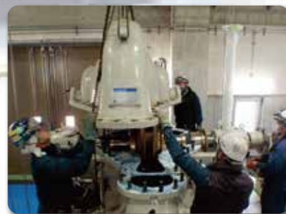
分解点検中のポンプ設備
