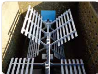
更新した浄水場の緩速攪拌機
