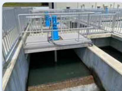
[急速かくはん池]
