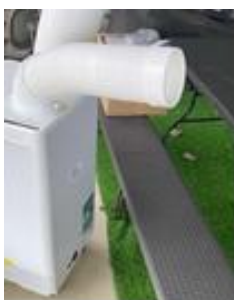
休憩所の空調機
