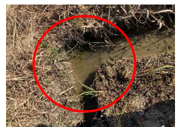
明渠の角がつながっている
