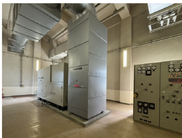
更新予定の芸濃送水ポンプ所非常用発電設備 （津市）
