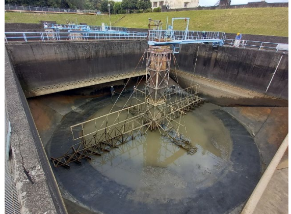
更新予定の山村浄水場 汚泥池掻寄機（四日市市）
